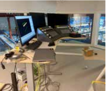
Kontrollrummet är under uppbyggnad. Fler skärmar ska upp.
